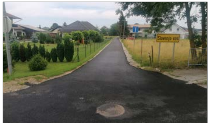
Vsa dela na kanalizacijskem omrežju bodo končana do konca julija 2023. Foto: TM
