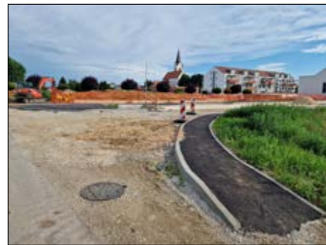
Delavci podjetja Asfalti Ptuj urejajo cestno infrastrukturo tudi na območju, kjer poteka komunalno opremljanje.
